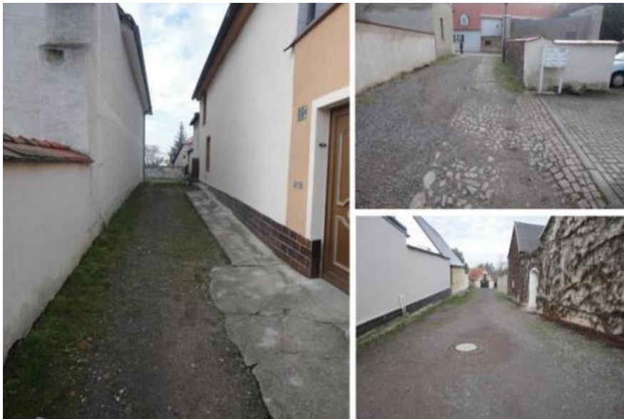
Abbildung 22 - Straßen im Sanierungsbedarf im Sanierungsgebiet (Fotos: Büro W&D 02/2016)
